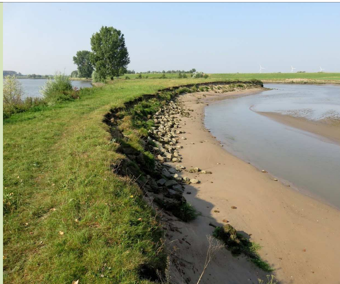
De Horde: afkalving oeverwal
